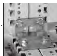
Vnútorné spájanie rozvádzačov
